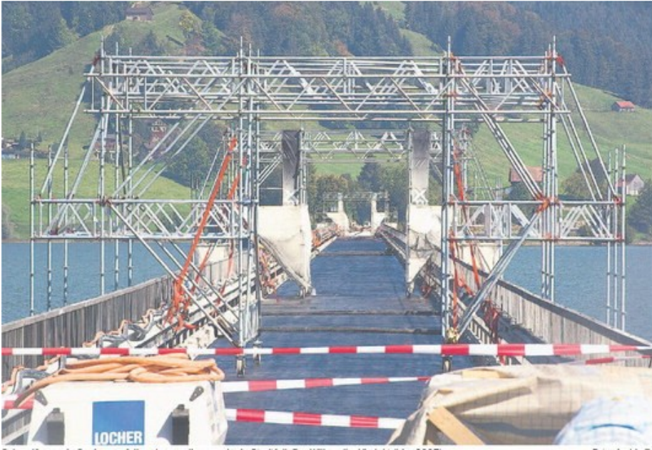
Schon länger ein Sanierungsfall und neuerdings auch ein Streitfall: Der Willerzeller-Viadukt (hier 2007). Foto:
